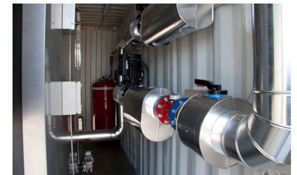
Detalle instalación hidráulica.
