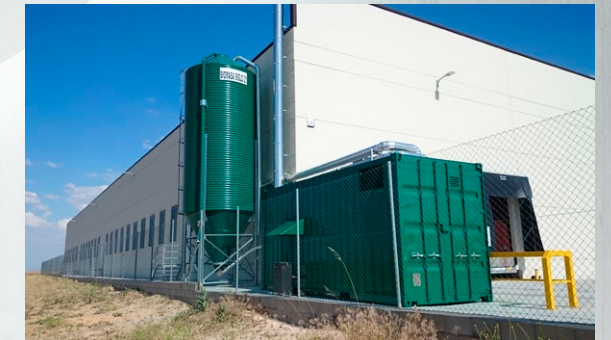
Instalación en secadero de jamones.
